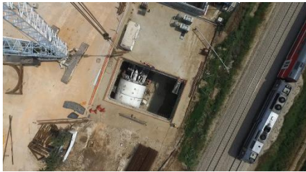
Startschacht Depot Portal vor Beginn der Vortriebsarbeiten für die erste Röhre, Mai 2017
