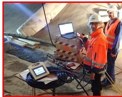
Steuerung und Durchflusssensor
