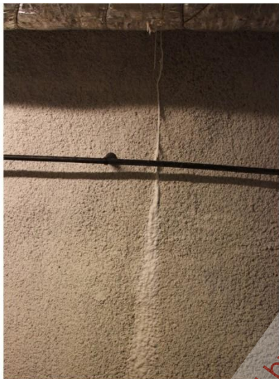
Verheilte Risse in Spritzbetonschale
